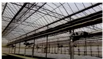
지열난방시스템이 설치된 하우스로 전기를 이용하여 여름에는 냉방이 겨울에는 난방이 되는 시스템이다.
